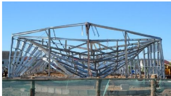
Рис. 1. Разрушение металлических конструкций ангара
